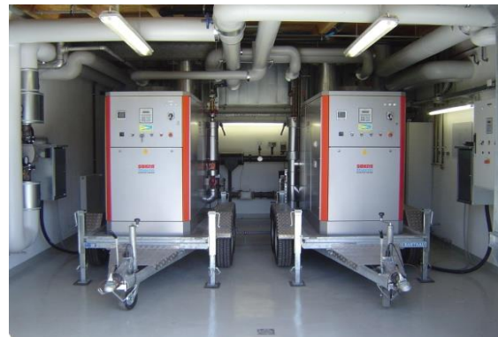
2 x (50 kW elektrisch 80 kW Wärme)
