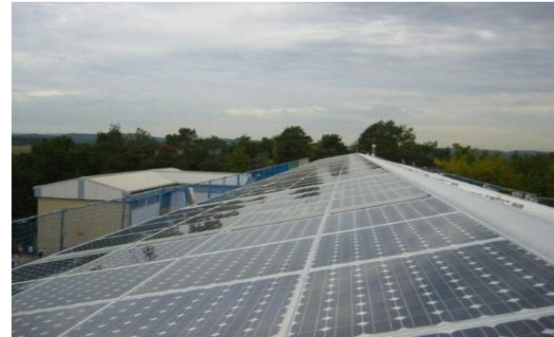
Grundschule E.-A. (30 kW)
